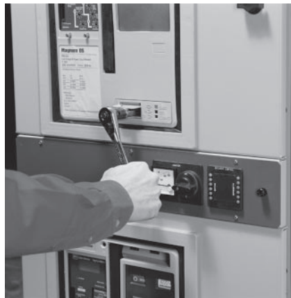
Levering Magnum DS Breaker
